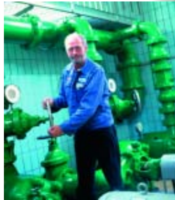
AUTOMATISIERUNG DER WASSER- VERSORGUNG — Auf den Menschen kann auch heute nicht verzichtet werden.
