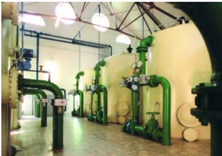
FILTERHAUS MIT KIESFILTER — Hier wird das Wasser trinkfertig aufbereitet.
